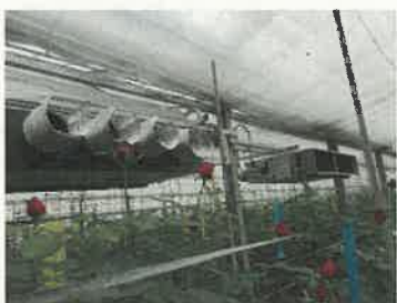
ばらハウスのヒートポンプ
