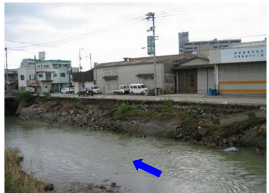
新居浜市 (二)東川 護岸崩壊
