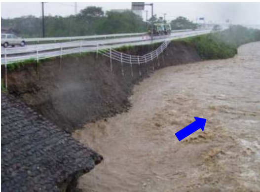
西条市 (二)中山川 護岸崩壊
