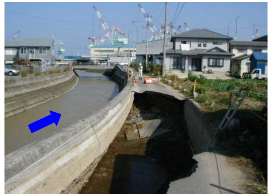
今治市 (二)山之内川 吸出しによる道路陥没
