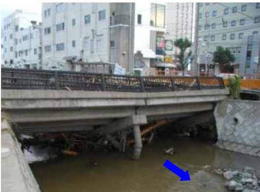
新居浜市 (二)尻無川 橋梁被災
