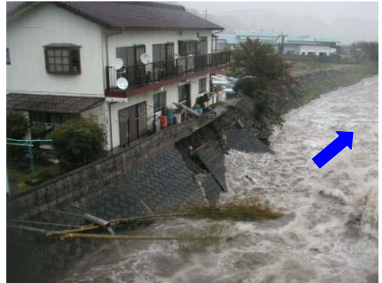
四国中央市 (二)関川 護岸崩壊
