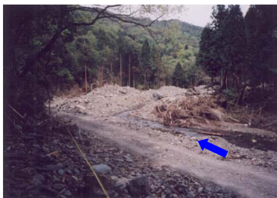
被災状況 護岸が流出し河道が埋塞
