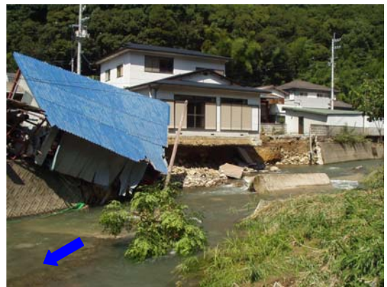
宇和島市 (二)薬師谷川 護岸崩壊
