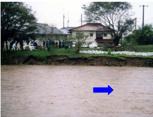
松山市 (二)立岩川 護岸崩壊
