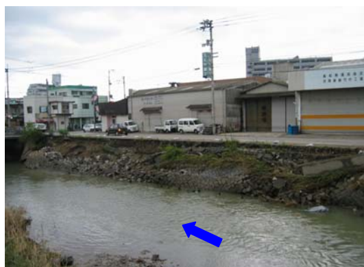
新居浜市 (二)東川 護岸崩壊
