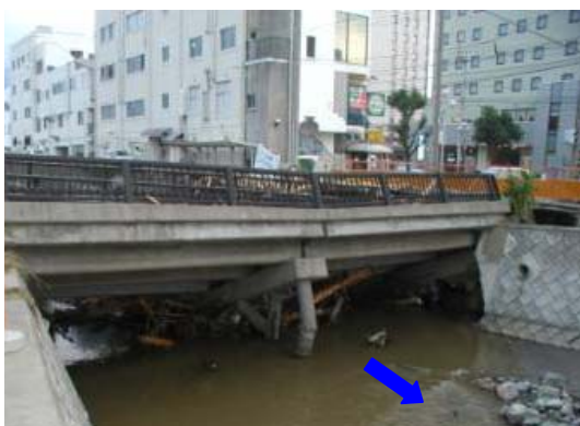
新居浜市 (二)尻無川 橋梁被災
