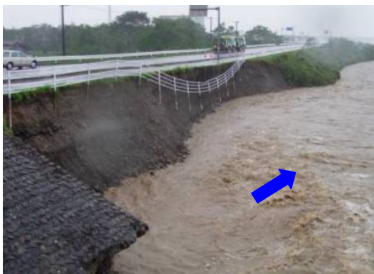
西条市 (二)中山川 護岸崩壊
