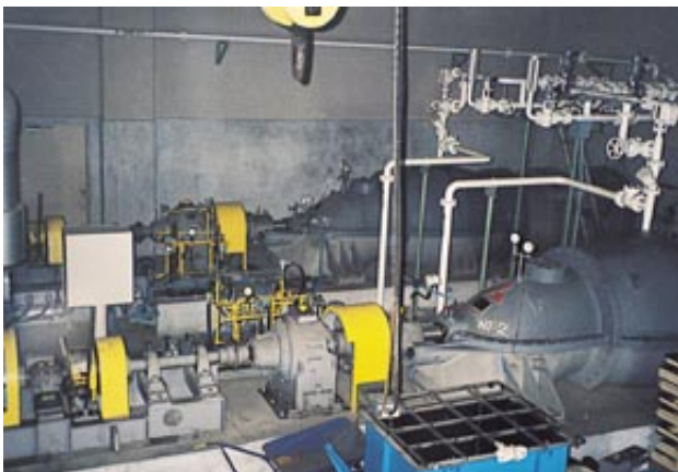
揚水ポンプ 王子川（新居浜市）
