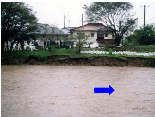
松山市 (二)立岩川 護岸崩壊
