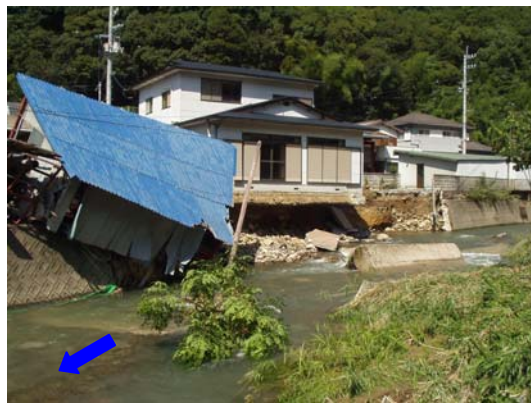
宇和島市 (二)薬師谷川 護岸崩壊
