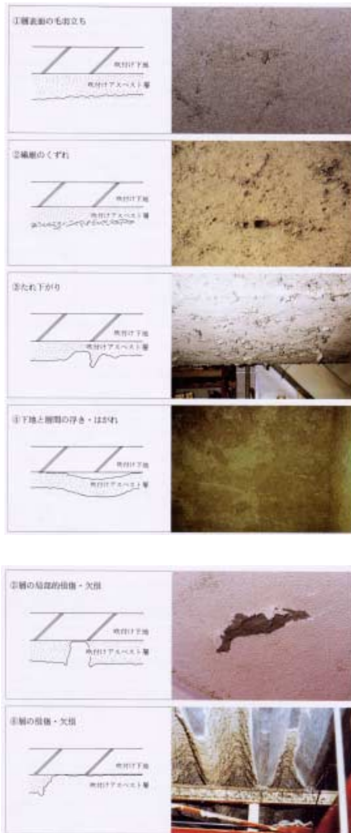
図表 22 吹付け石綿の劣化損傷の状態
