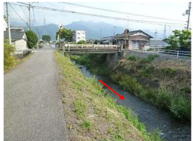
写真 4-6 未整備状況 (SP. 3400)
