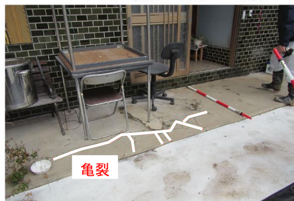
ブロック内家屋の土間への亀裂
