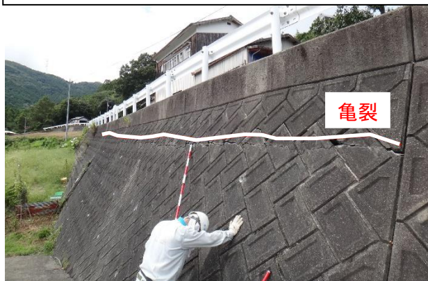
①福住A-I(上)ブロック頭部の擁壁に生じたクラック
