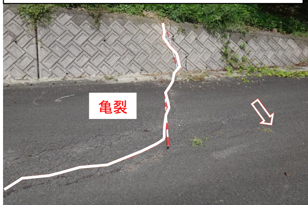
②福住Dブロックの市道と擁壁に生じたクラック
