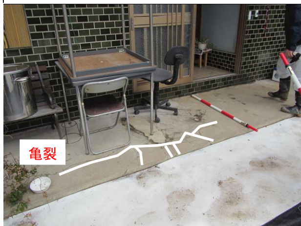
③平村Bブロックの家屋の土間に生じたクラック
