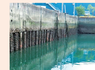
老朽化した港湾施設
