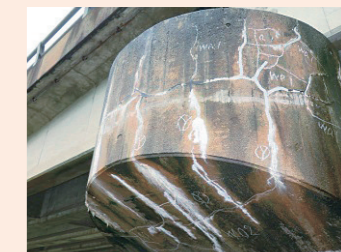
老朽化の進行した橋脚
