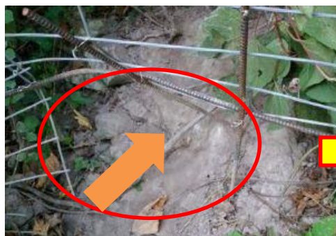
イノシシの侵入穴（修繕前）
