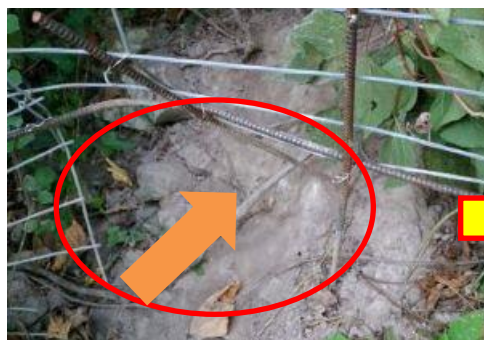
イノシシの侵入穴（修繕前）
