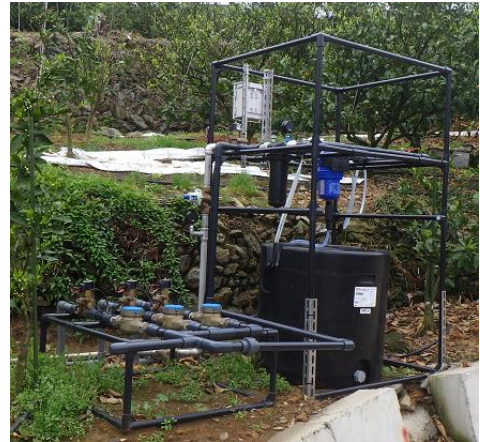
南予用水を利用したマルドリ施設
