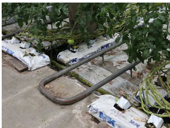
作業用レールと暖房を兼ねたパイプ
