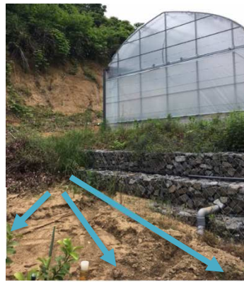
整備後の法面などから雨水が集まり、削れた土砂が下段の園地に流入 ( → : 土砂の流れる方向)
