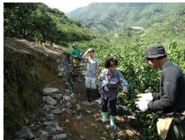
崩壊した石垣
