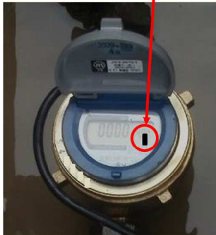
水道メーターのパイロット
