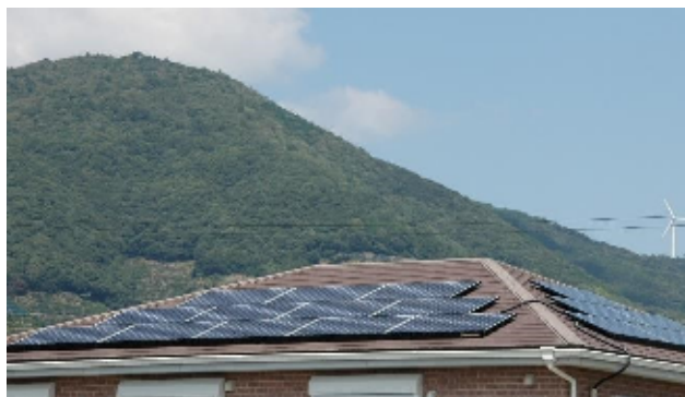
住宅に設置された太陽光パネル
