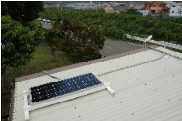
ゴミステーションへ設置したオフグリッド発電設備
