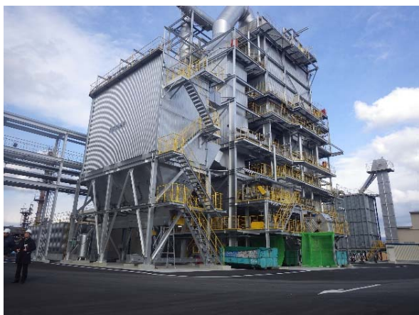
木質バイオマス発電所 (松山市)
