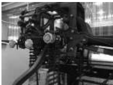
台帳に掲載されていない機器
