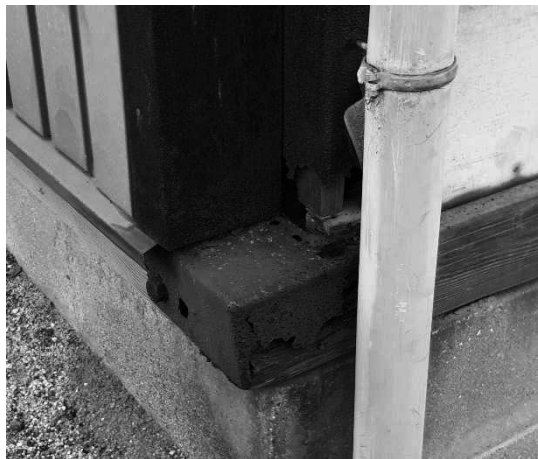
躯体の損傷が激しい建物
