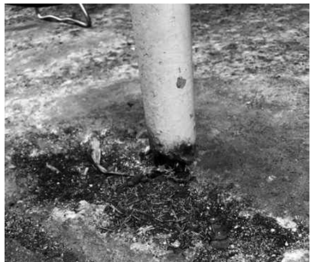
外灯接地部の腐食
