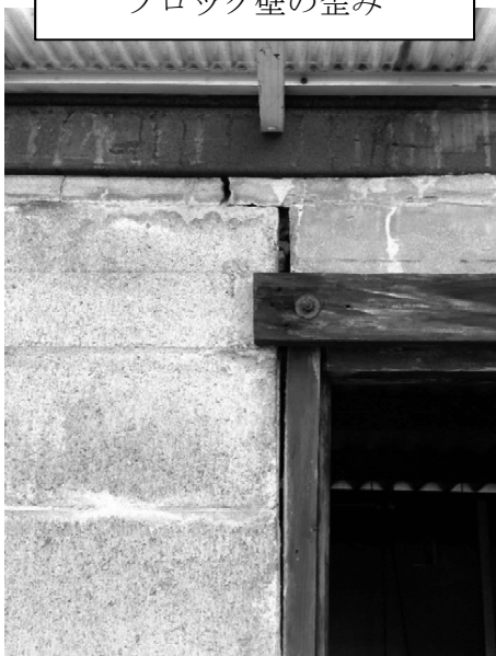
ブロック壁の歪み
