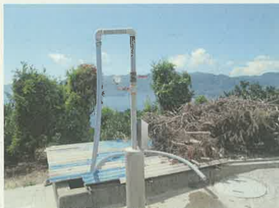
制御室 既存取水スタンド
