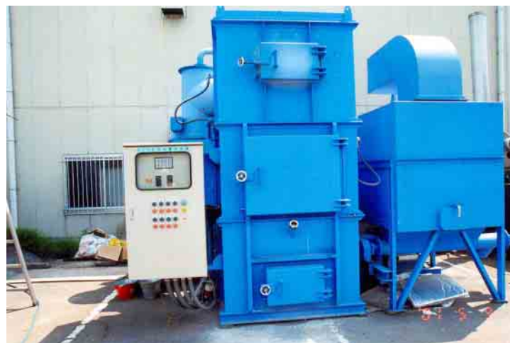
えひめ方式試験焼却炉
