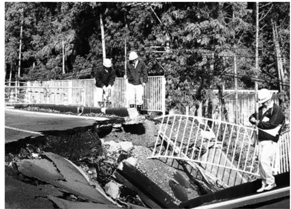
配水管の損傷(大洲市名荷谷簡易水道事業)
