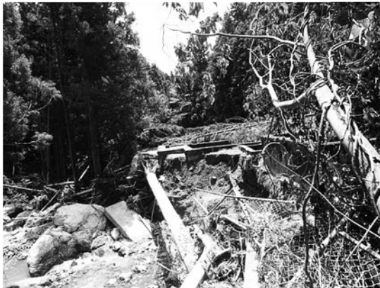
浄水場(下川浄水場)の埋没 (西予市下川浄水場)
