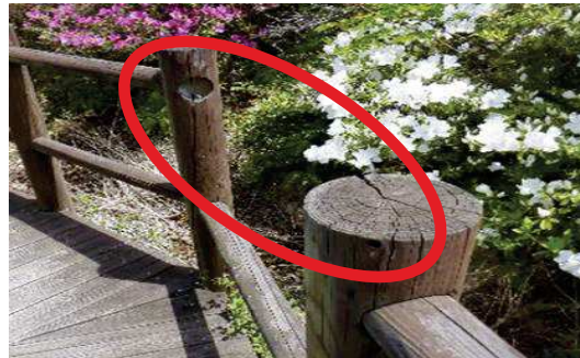
木柵が欠落した遊歩道
