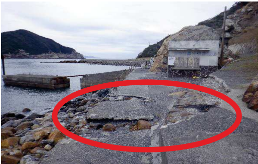
舗装が損壊した遊歩道
