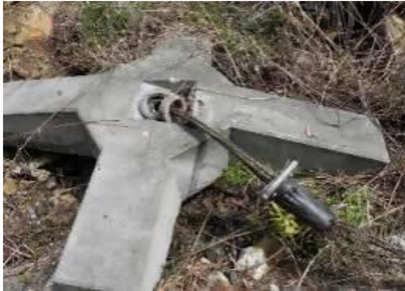
アンカー番号:A-4 頭部の飛び出し
