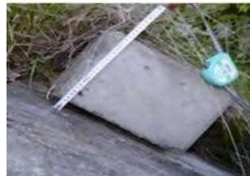
アンカー番号:A-6 頭部コンクリートの浮き上がり
