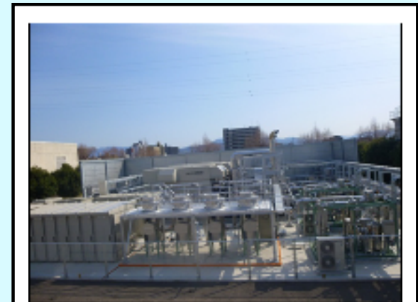
消化ガス発電設備全景
