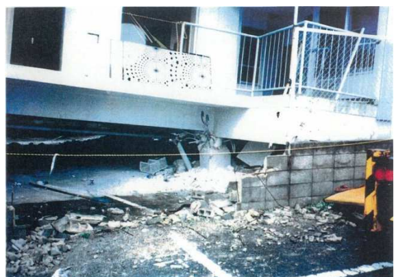
H13 芸予地震 全壊したマンション（今治市）
